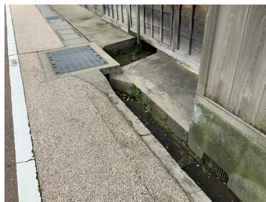
写真 17 二つの水路の取入れ口
