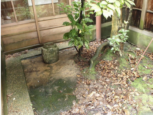
写真 27 そとにわ 滞水の様子
